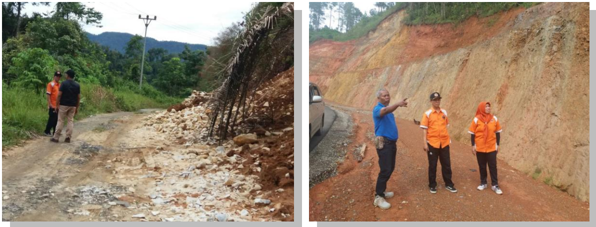
Gambar 3.14 Pelaksanaan Kegiatan Monitoring dan Evaluasi Kegiatan Rehabilitasi dan Rekonstruksi Pasca Bencana Tanah Longsor di Kabupaten Tanah Datar tahun 2018
